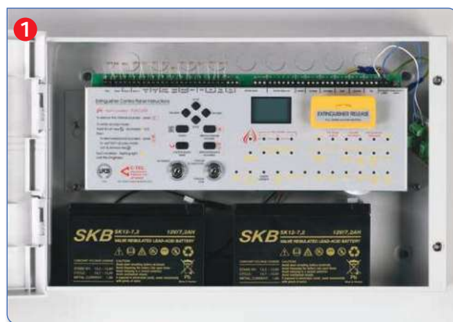
Centrale di spegnimento automatica
